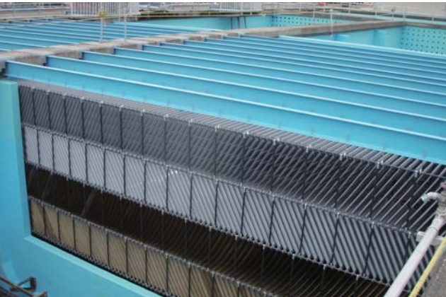
上水施設 (着水井、沈澱池)
